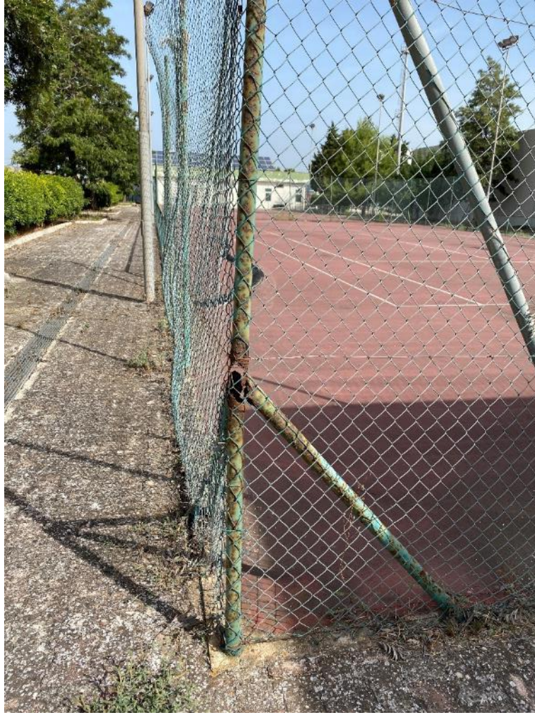
Foto 11: Campi da tennis. Particolare recinzione da sostituire.
